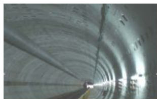
隧道安全监控
